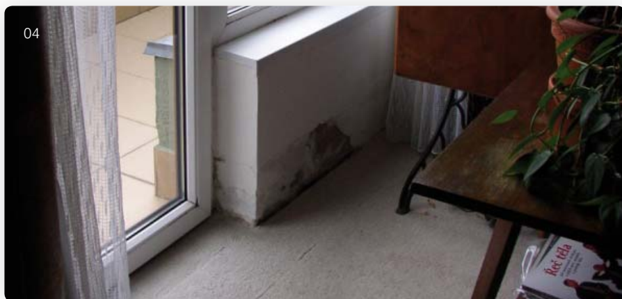
Voda proniklá pod podlahu pokoje vzlíná do stěnových konstrukcí
