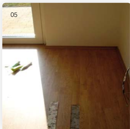
Plesnivějící podlahová krytina
