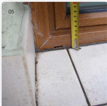
Odvodnění funkční spáry balkonových dveří
