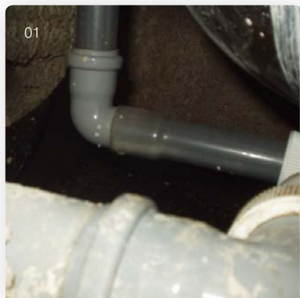
Vlhká stěna za vanou
